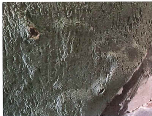
Présence d'humidité en partie basse de l'immeuble causée par le manque de ventilation.
