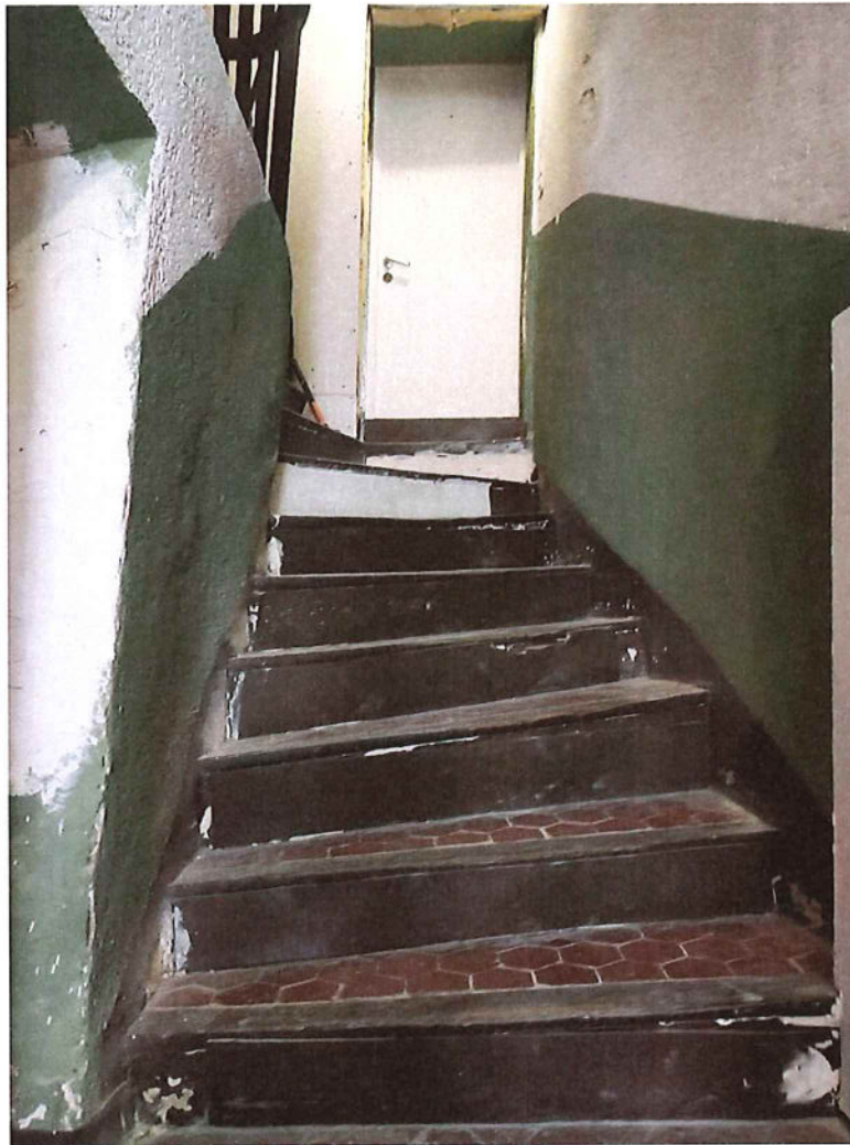
Vue de la première volée d'escalier avec forte inclinaison des marches vers l'intérieur. On note également sur la gauche, un gonflement de l'enduit peint de couleur verte.
