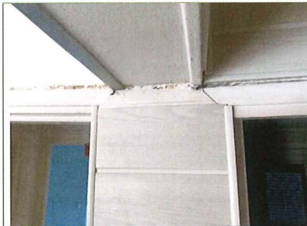
Photo n°7.: Affaissement du refend dans l'appartement Est au 1 er étage
